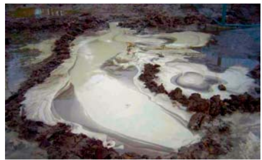
Fot. 3. | Zmiana koloru płynu wypełniającego odwiert HDD, świadcząca o wyparciu płuczki wiertniczej z otworu przez Drill-mix®
