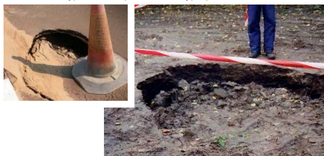
Fot. 2. | Zapadlisko powstałe po przewierceniu HDD, w którym nie ↑ zastosowano wypełnienia przestrzeni pierścieniowej
