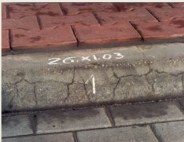
Rys. 4. Uszkodzenia betonu na skutek działania mrozu.
