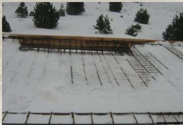
Rys. 2. Błędy zabudowy mieszanki betonowej – oblodzone zbrojenie
