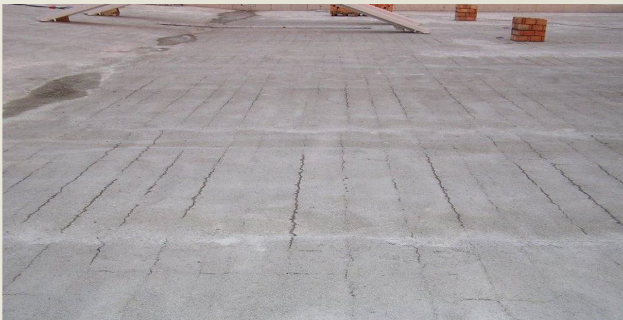
Rys. 9. Rysy powierzchniowe nad zbrojeniem płyty stropowej wskutek skurczu plastycznego betonu
