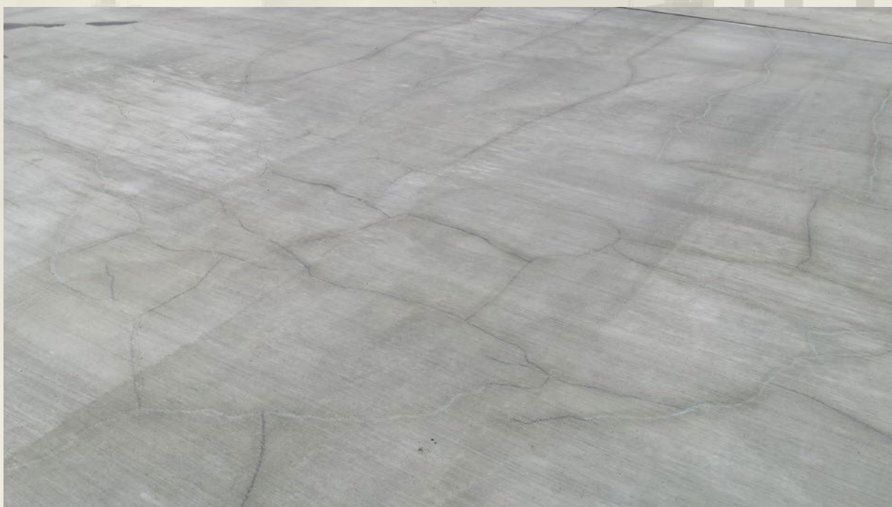
Rys. 10. Rysy na powierzchni betonu wskutek skurczu przy wysychaniu
