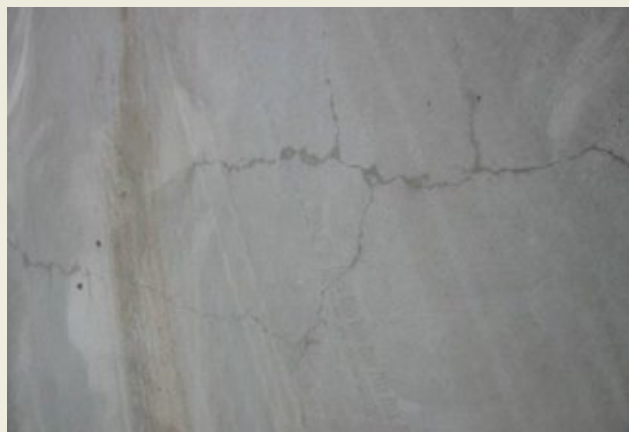
Rys. 3. Uszkodzenie powierzchni betonu na skutek „szoku” termicznego
